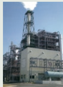
川崎バイオマス発電所
