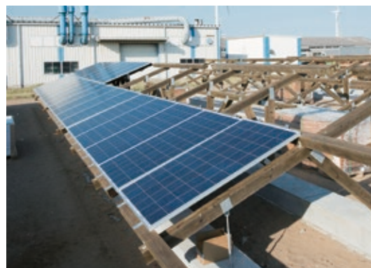
太陽光パネルと環境にも配慮した木製架台
